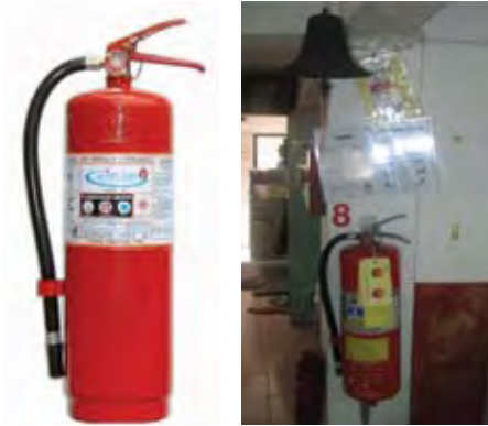
ถังดับเพลิงแบบเคลื่อนย้ายได้
